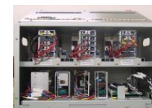
大型ユニット電源
